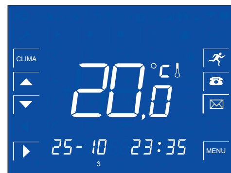
Pantalla principal con la alarma desactivada
